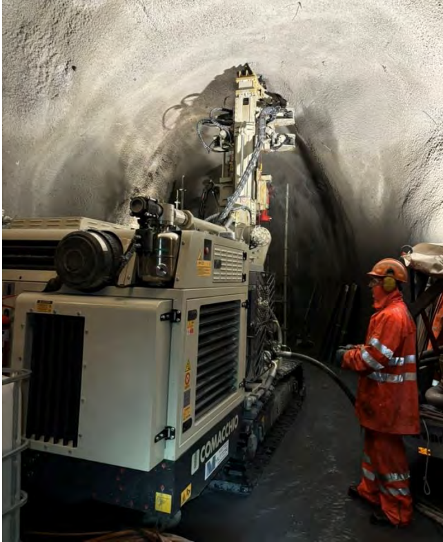
Drainagebohrung in die Rutschmasse DR4 (vertikal nach oben mit einer Länge von 100 m)
