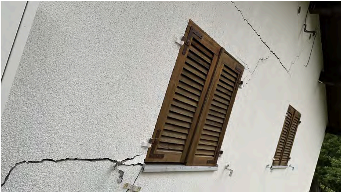
Schäden an einem Gebäude in Brienz/Brinzauls
