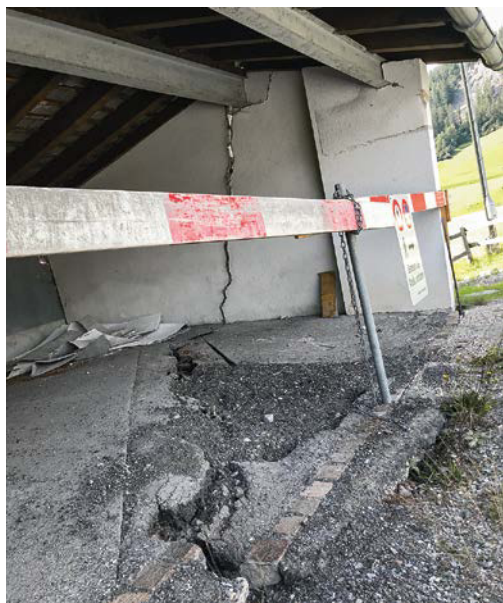
Abb. 5: Schäden an Gebäuden und Infrastrukturanlagen machen die Auswirkungen der Rutschung Dorf zunehmend sichtbar. (Bild: AWN)
