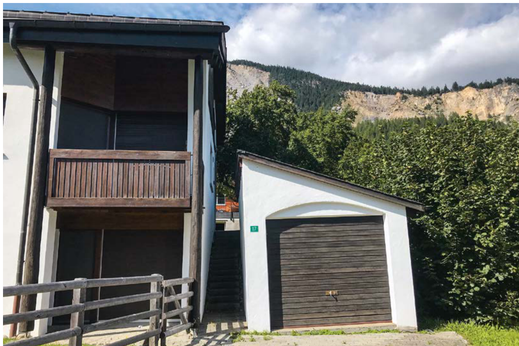
Die Rutschung verursacht Schäden im Dorf: Ganze Gebäudeteile, wie die hier abgebildete Garage, können verkippen.
